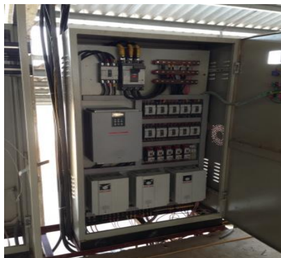
Tủ điện lò lắp biến tầng
