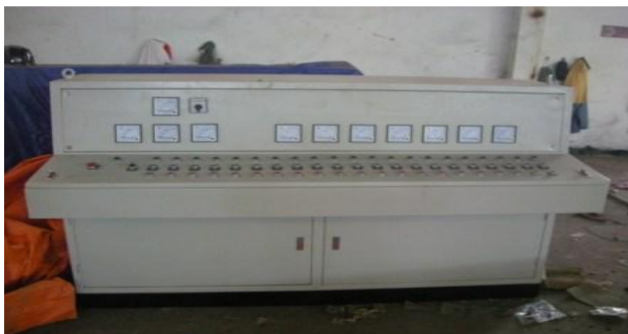
Tủ vận hành thiết bị chế biến tạo hình
